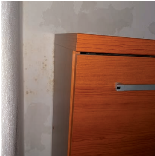
Obr. 8 - Kolizní jev jako výsledek snížení hodnoty h_{si} vlivem zateplení obvodové stěny v kombinaci s nedostatečnou cirkulací vzduchu a sálání vnitřního povrchu obvodové stěny kvůli přistavenému nábytku.
