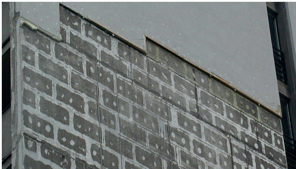
Obr. 9 - Količní jev ztráty stability ETICS v důsledku sání větru jako výsledek nesprávné aplikace lepení desek tepelné izolace.
